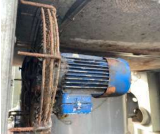
Motor Instalado/Operando 300kW, 4 polos, 1997
