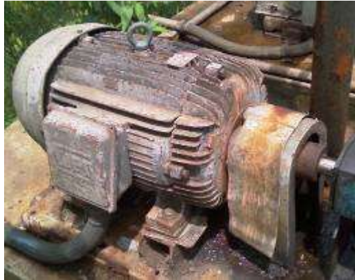
Motor Instalado/Operando 75 CV, 4 polos, 1997
